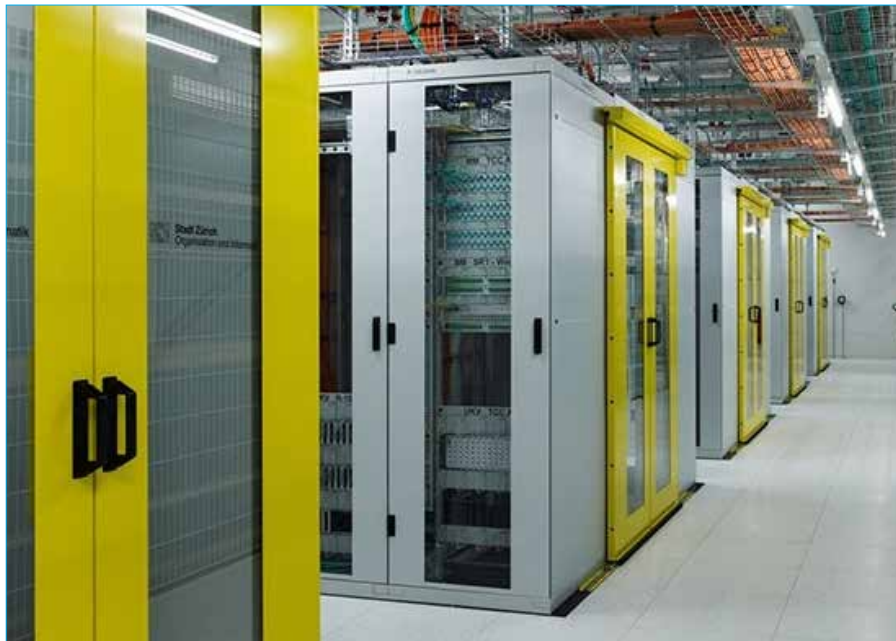
Warme Abluft aus dem Rechenzentrum der städtischen Informatikabteilung (OIZ) wird in das Energienetz auf dem Hunziker Areal eingespeist.
