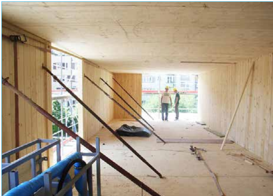
Ansicht des Rohbaus im 2000-Watt-Gebäude «Badenerstrasse», das mit tragenden Holzwänden erstellt worden ist. Dasselbe Konstruktionsprinzip soll auch bei Haus J auf dem Huniker Areal zum Einsatz kommen.
